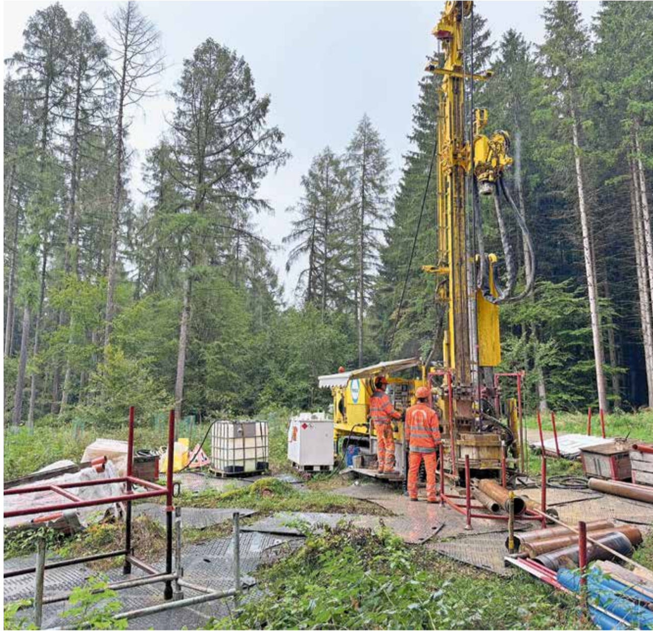
Die Bohranlage läuft nur werktags und tagsüber. Für ihre Platzierung musste kein Wald gerodet werden.
